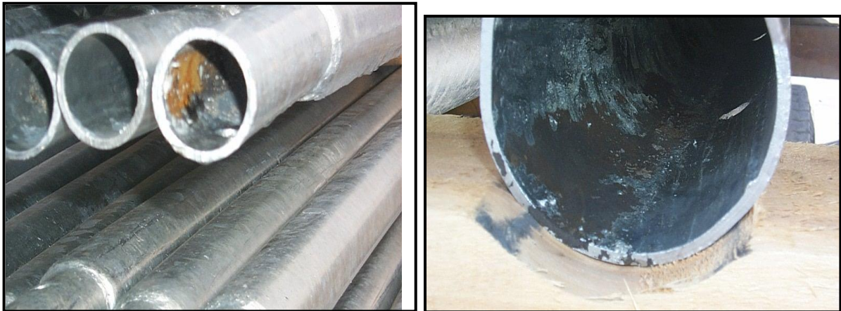
Resim 12 - Borularda kaplanmamış bölgeler
